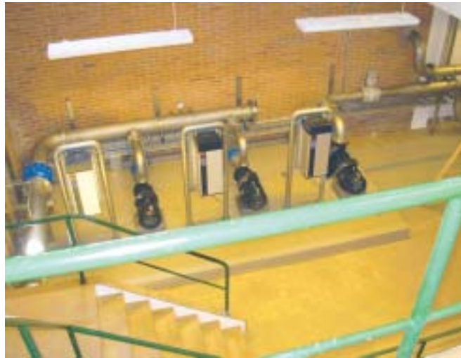
Projektet omfatter renovering af bygninger og opførelse af tilbygning, udskiftning af maskinanlæg, el- og SRO-anlæg, profilbaneblufter m.v.
