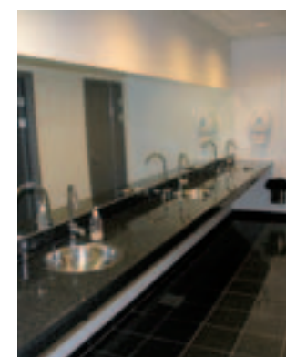
Det fornægter sig ikke, at det er vand og VVS m.v., koncernen beskæftiger sig med. Her ses et af medarbejdertoiletterne
