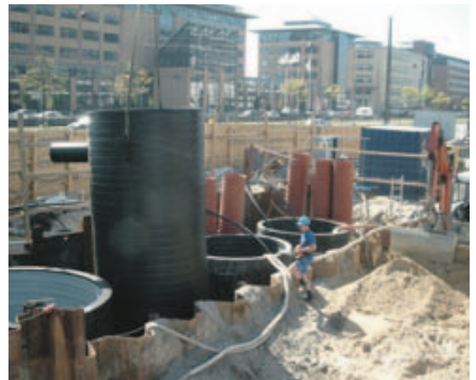
Samtlige tanke er placeret i en "tankgrav" langs Kalvebod Brygge.
