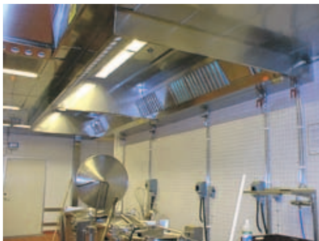
- Udsugningsanlæg med fedt- og olie-rester fra køkkener kan være de rene brandfælder, men vores systemer nedsætter denne fare betydeligt, siger Jimmy K. Larsen
