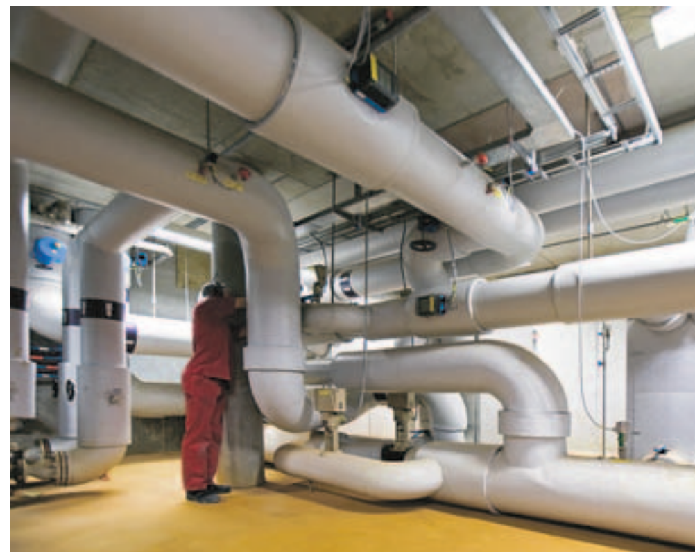
Et af energispareinitiativerne hos Færch Plast er grundvandskøling. Fem borepumper udvinder koldt grundvand til nedkølingen. Vandet cirkulerer gennem et lukket system og sendes derefter tilbage til undergrunden. Gennemsnitstemperaturen på grundvandet ændres ikke over en periode på et år. Om vinteren udvindes det opvarmede vand for anden gang til opvarmning af kontorer og lagre og returneres koldt
