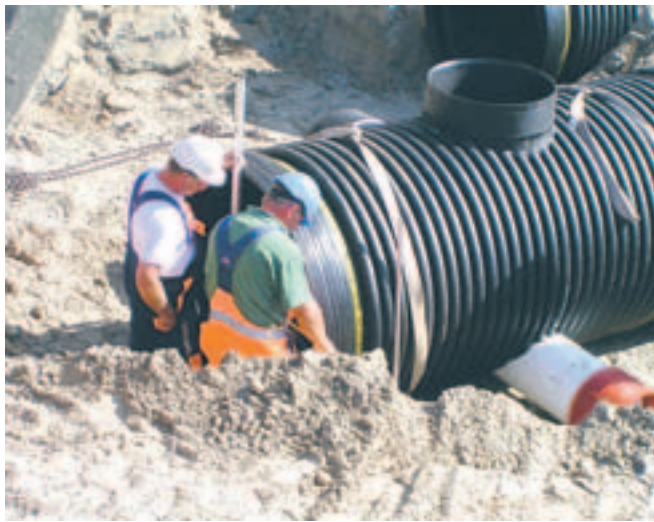
Der blev i Frederikshavn installeret 2 parallelle rørstrækninger på 100 m til den ene side samt 2-parallelle rørstrækninger på 325 m til den anden side. I alt 850 m rør med et samlet volumen på ca. 1.300 m 3 . Rørene blev installeret som parallelle ledninger og med jorddækning ned til 0,6 m
