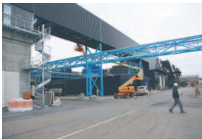
For at kunne flytte affaldet fra modtageanlægget til de andre behandlingsfaciliteter kræver det en ny kran med tilhørende kranbro
