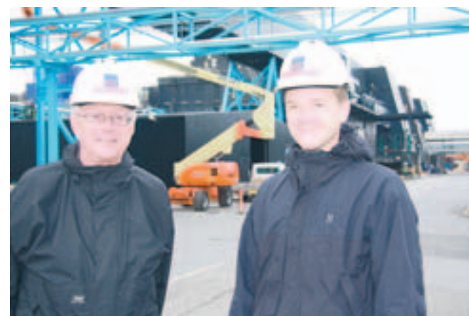
Det nye modtageanlæg og en ny kranbro gør Kommunekemi klar til at behandle og nyttiggøre endnu større mængder fast affald som f.eks. tomme malerbøtter og andre typer farligt industriaffald, forklarer Ole Kristensen (tv) og Jesper Hansen
