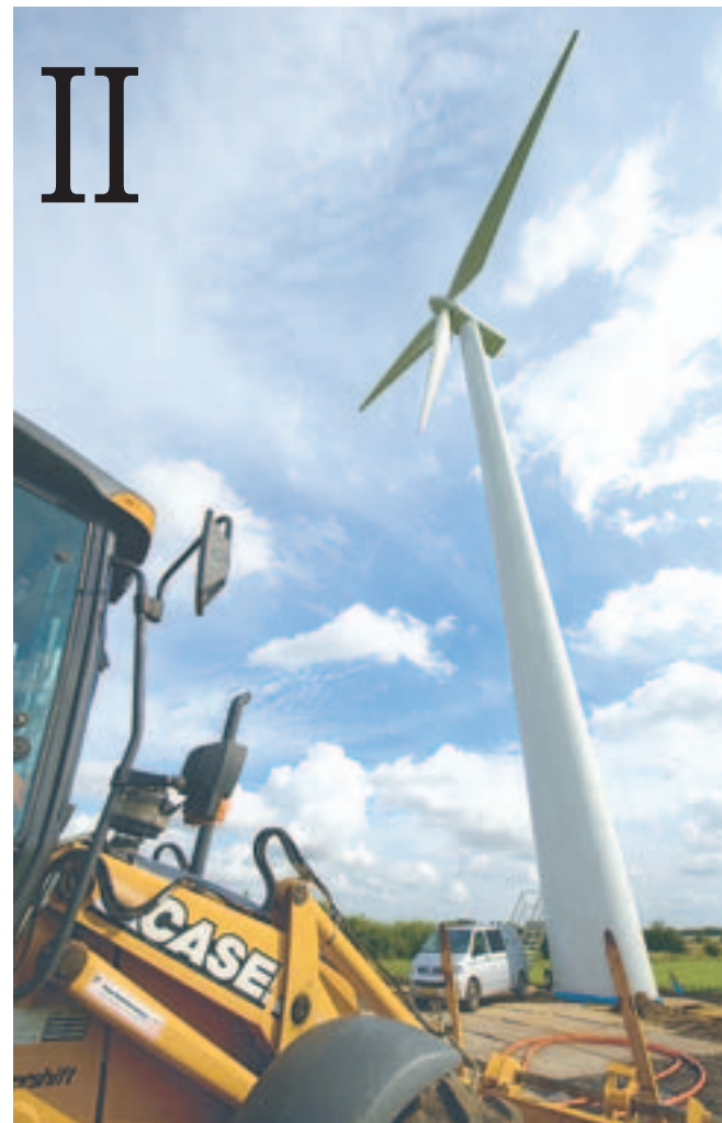
Energi Danmark Vind ApS har blandt andet erhvervet to nyopførte vindmøller af typen Vestas V52 i Vejen Kommune. Møllerne har et nominelt output på 2 x 850 kW. Den beregnede årsproduktion er på 4.000.000 kWh. Møllerne er projekteret og opstillet i Gamst
