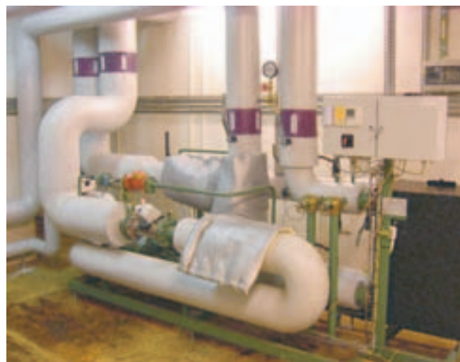
Vestforbrænding har etableret 34 nye fjernvarme undercentraler i Herlev-området som erstaning for CO2-belastende naturgasfyr. Armatec har leveret centraler som færdige Prefabenheder
