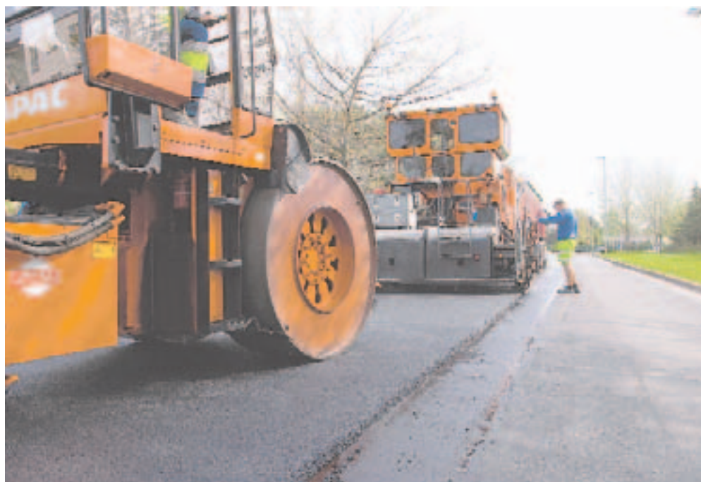
Pankas er begyndt at producere asfalt ved en lavere temperatur. Det betyder lavere energiforbrug, lavere CO 2 -udledning samt mindre røgdudvikling ved udlægningen. Her lægges asfalt på Duemosevej i Rudersdal Kommune
